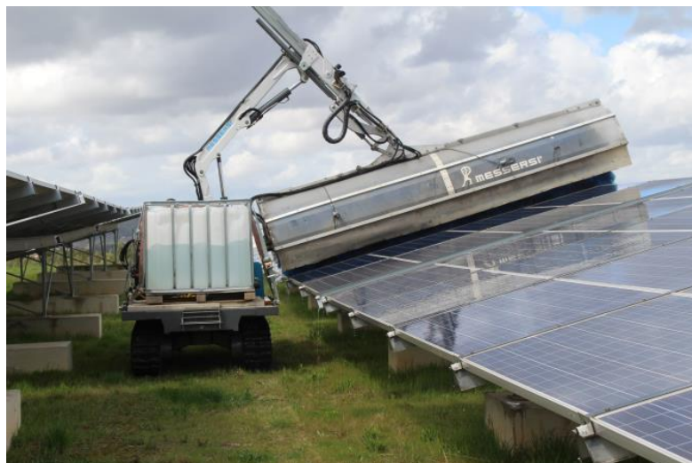
Nettoyage des panneaux avec engin dédié (Source : Urbasolar, droits réservés)
